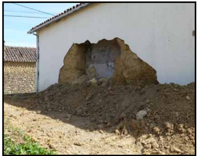
Effondrement d'un bout de mur enfermé entre un enduit ciment et des blocs de parpaing
