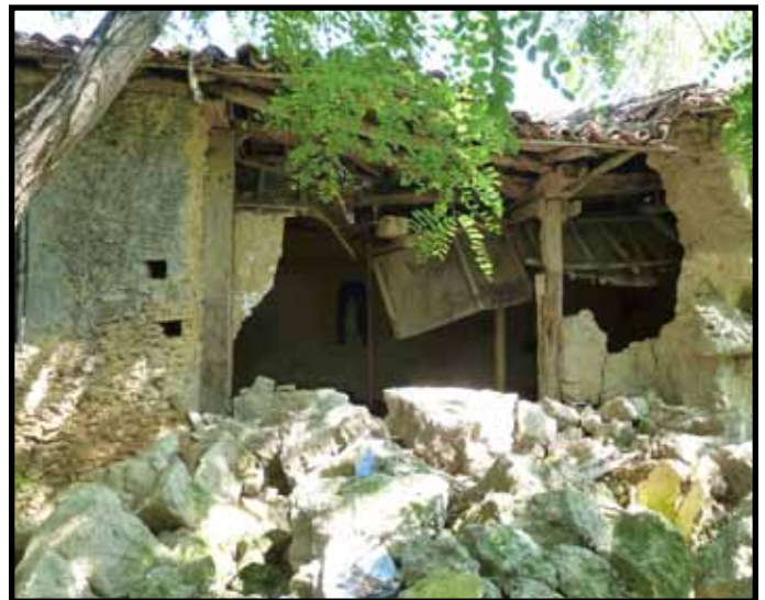
Effondrement d'un mur à cause d'une toiture abîmée (poussée de la charpente et infiltration d'eau)
